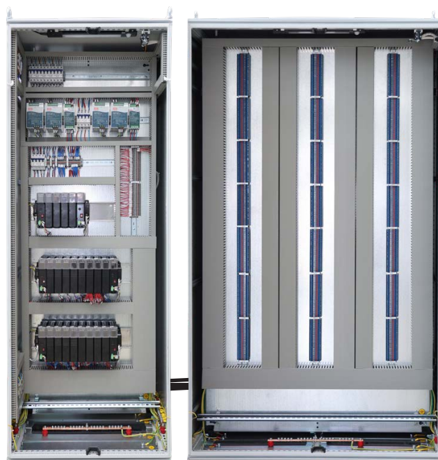
Шкаф управления и кроссовый шкаф.
